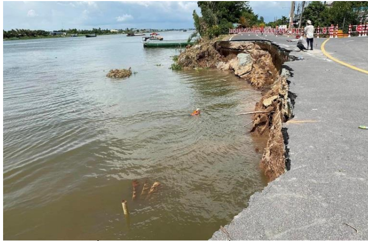
Hình 8: Cảnh sạt lở đất dọc theo hai bên bờ sông Tiền Giang và Hậu Giang đang xảy ra hầu như rất thường xuyên. Dưới đây là điểm sạt lở quốc lộ 91 tại xã Bình Mỹ hôm 27 tháng 5 năm 2019, ảnh internet.
