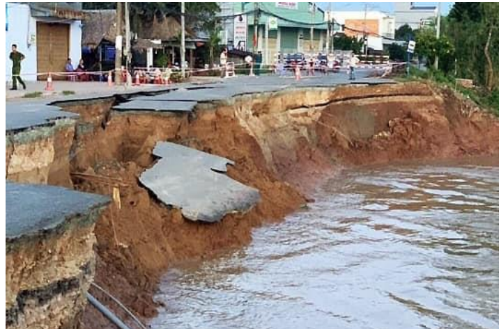
Hình 9: Cảnh sạt lở đất dọc theo hai bên bờ sông Tiền Giang và Hậu Giang đang xảy ra hầu như rất thường xuyên. Dưới đây là điểm sạt lở quốc lộ 91 tại xã Bình Mỹ hôm 27 tháng 5 năm 2019, ảnh internet.
