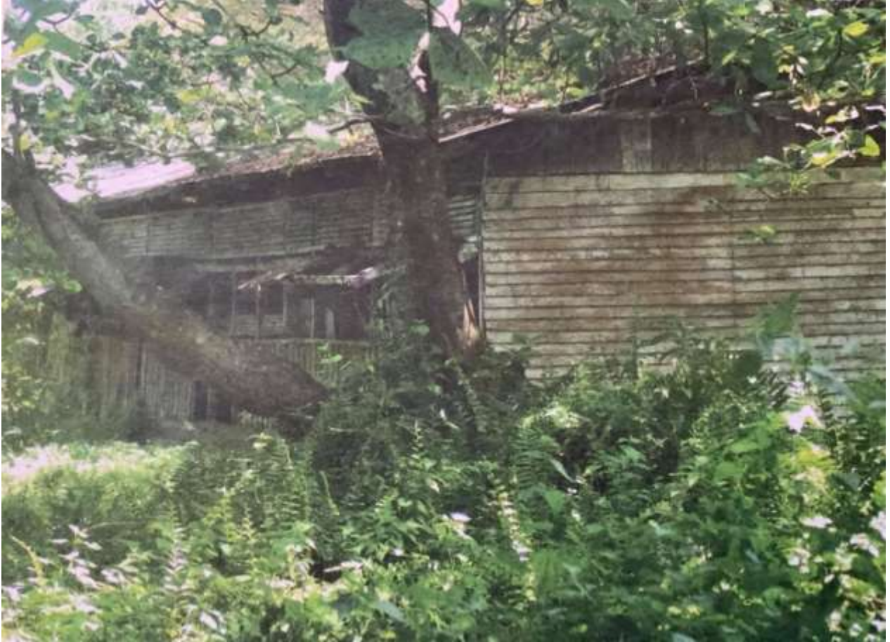
Hình #5: Những khu Longhouses đã bị hư hại gần hết, 2008.
